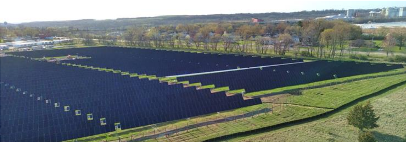
Ottawa Solar Array
